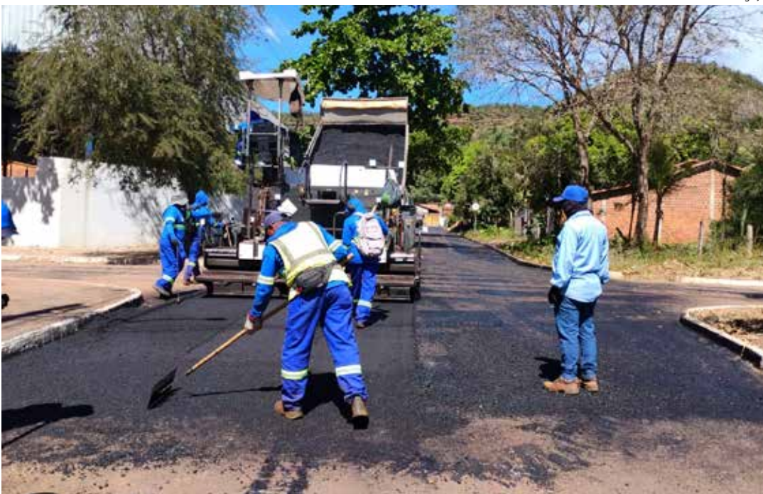
Execução dos serviços de recapeamento asfáltico de vias foi iniciada pela Rua 10.
